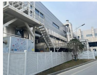
(废气处理装置)
