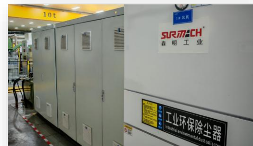
在线设备除尘
